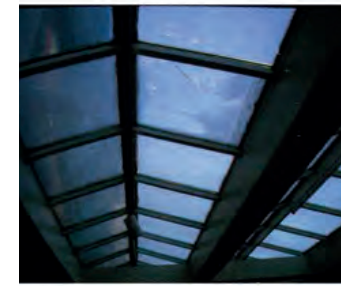
Schadhafte Glasscheiben am Oberlicht Damaged skylight panes
